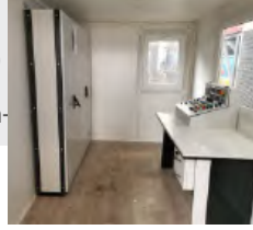
*Siemens/ABB şalt malzemesi *Omron/PLC *Dizüstü Bilgisayar *Manuel Kontrol (Mimik) *Klima: Mevcut (9000 btu)
